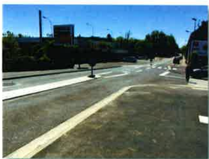
Amiens – rue Robert Le Coq Amélioration du franchissement du passage à niveau Travaux complémentaires : aménagement d'une voie de tourne-à-gauche
