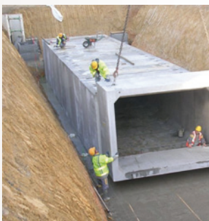
Bassin en génie civil préfabriqué © bonnasabla
