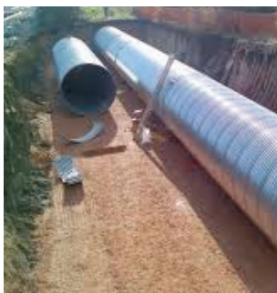
Bassin en tuyau surdimensionné © turbosiduu
