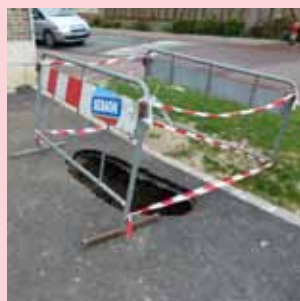
Un effondrement de la chaussée
