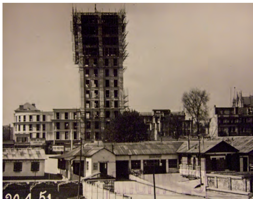
Construction de la tour Perret à Amiens, 1949–1952. AMCA, coll. part. 871, crédit photo : Archives municipales et communautaires d'Amiens.
